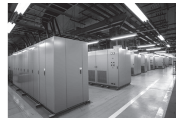
● DCでは安定した電力供給を実現しています
